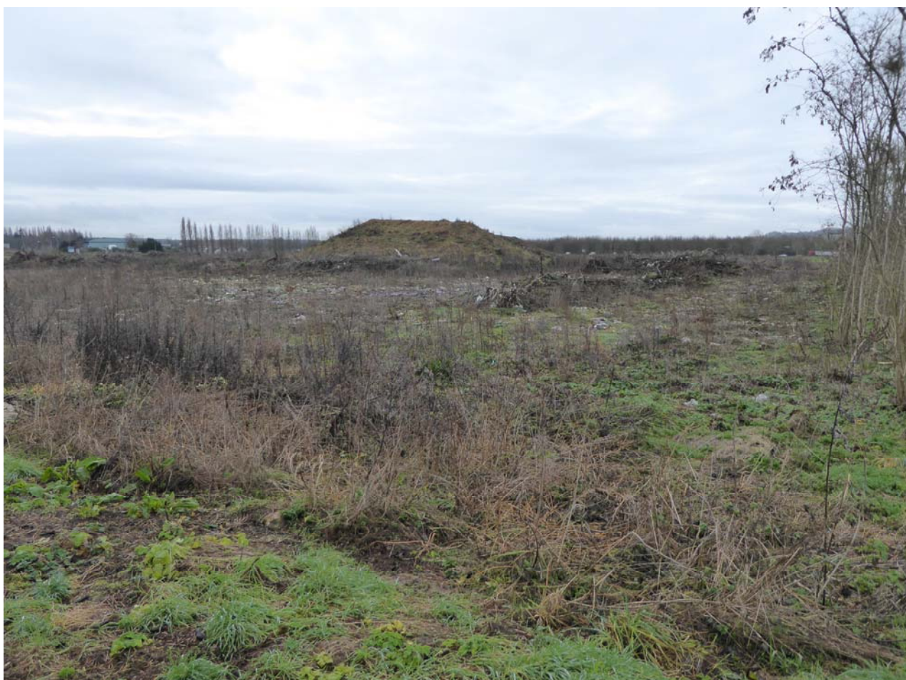
Travaux de déboisement/terrassement réalisés sur la parcelle au sud du boisement nitrophile concerné par le projet. Ces travaux remettent en cause la présence de la Tourterelle des bois et peut-être aussi de la Rousserolle verderolle sur le site.
